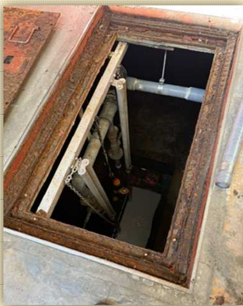
↑地下ピット 排水ポンプの一例
