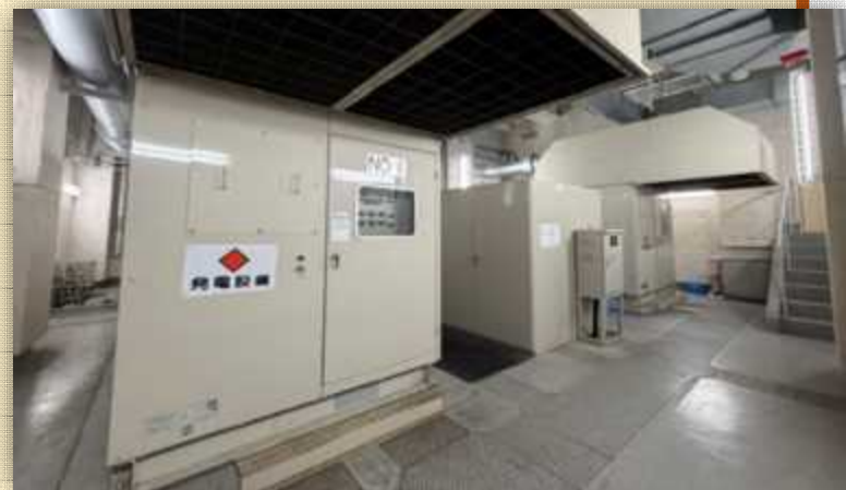
↑非常用発電装置 2基
